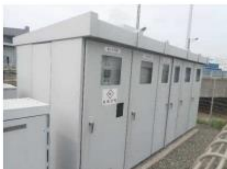
[図1] キュービクル(高圧受電設備)
